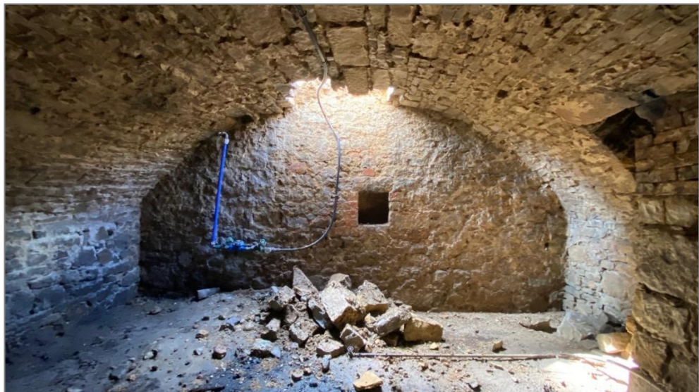
Abb. 31: Bockenem FStNr. 7, Blick auf die Schildmauer des Gewölbekellers nach dem Einsturz. (Foto: Lisa Wildeboer, 20.04.2022)
